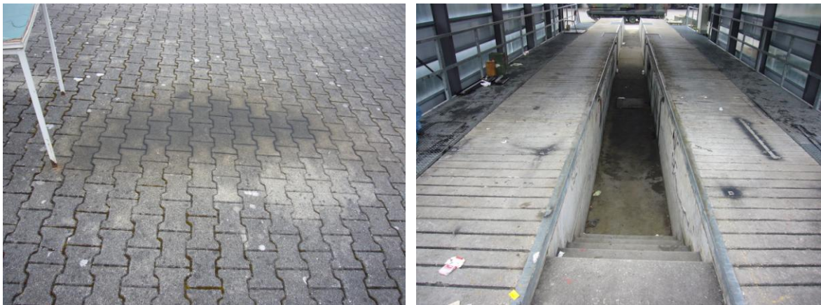
Abb. 22: Ölverunreinigungen vor der Ölwechselrampe Y1 [96], Wartungsgrube
